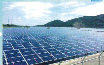
富津ソーラー発電所
